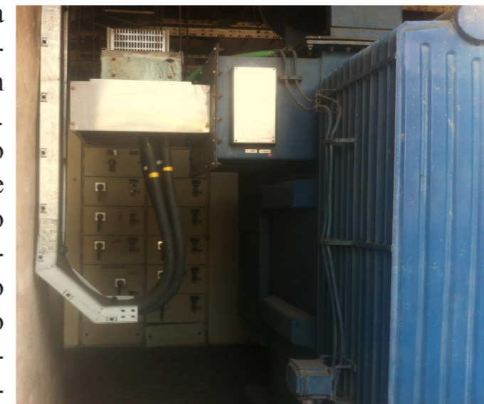
SUBESTAÇÃO DE ENERGIA NO CM
